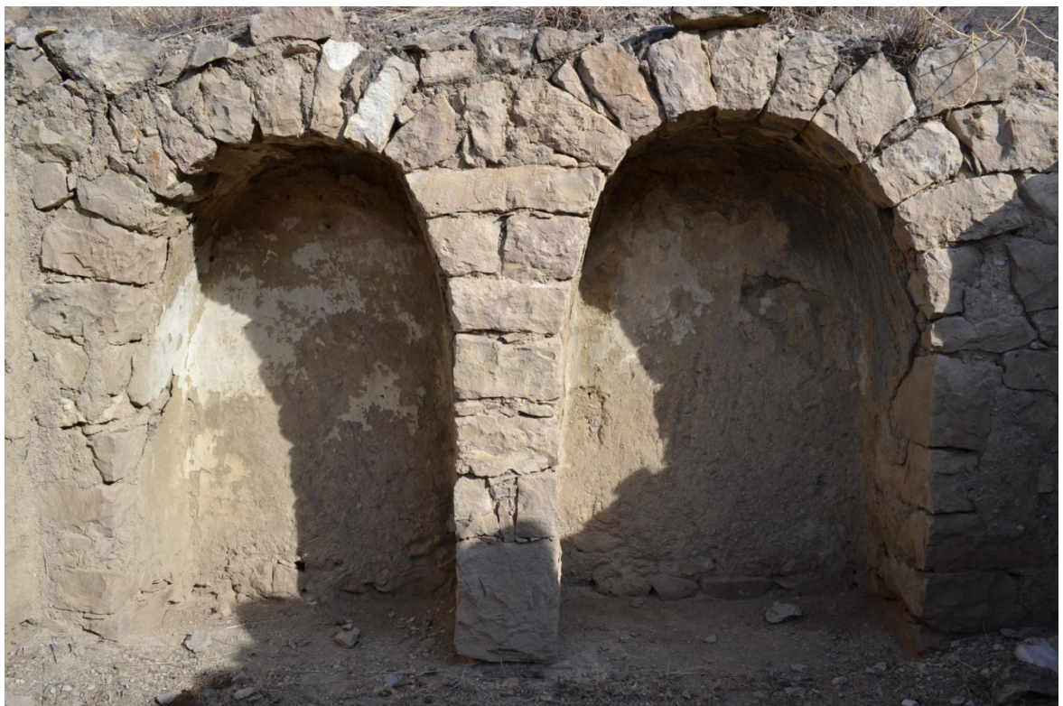
Арочная конструкция разрушенного дома
